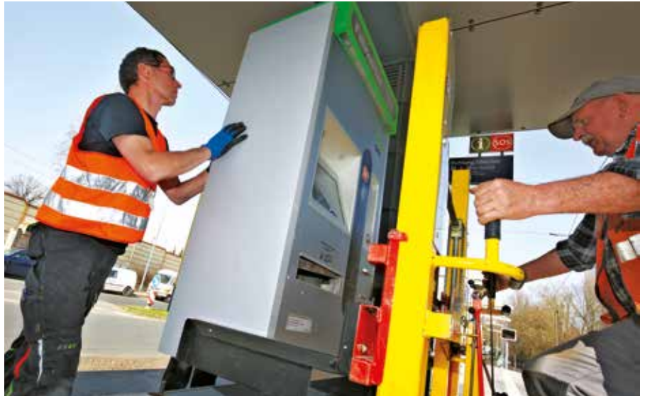
Totalschaden am Automaten an der Haltestelle Ginsterweg
